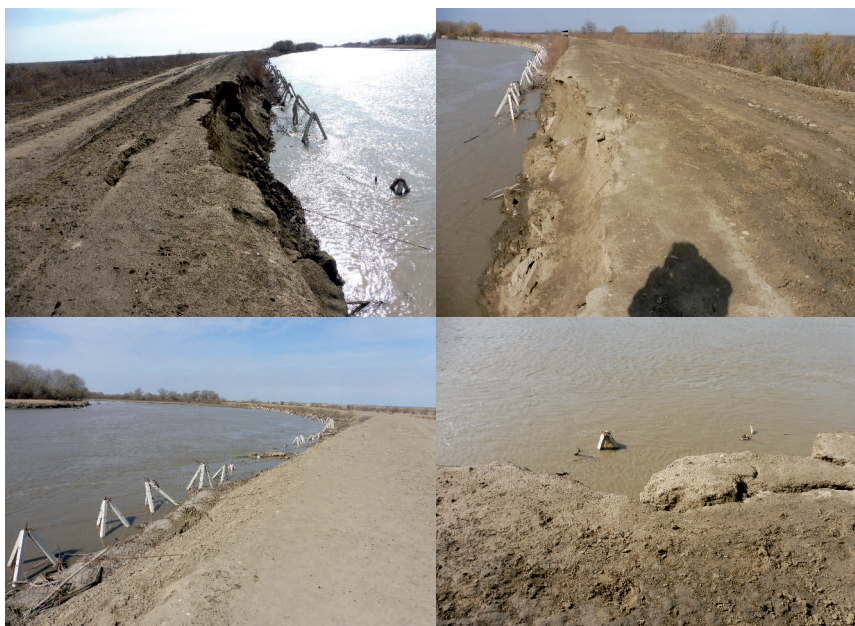
Рис. 10. Современный размыв левобережных береговых валов на участке 71–75 км
